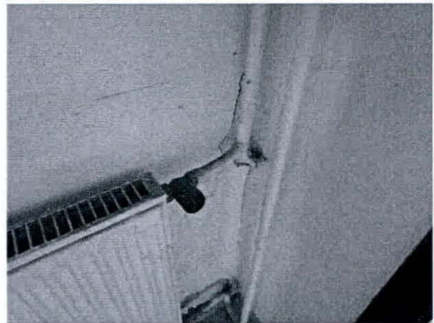
29. repedés a falazaton
