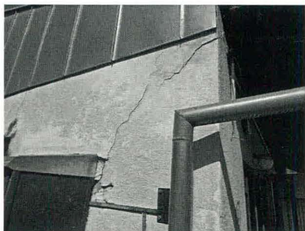
08. repedés a házfalon
