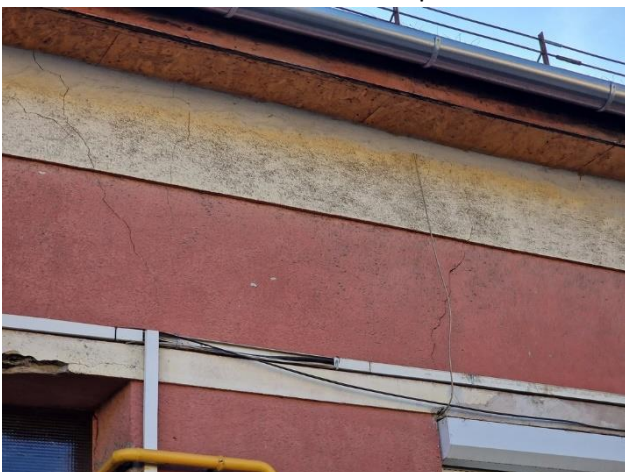
04. repedések a házfalon
